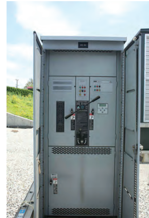
EXISTING TRANSFER SWITCH ATS-RO
